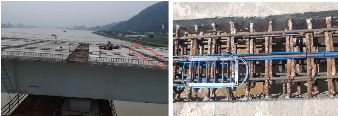
图 4. 温州七都大桥桥面伸缩缝内安装的多只阳极梯
